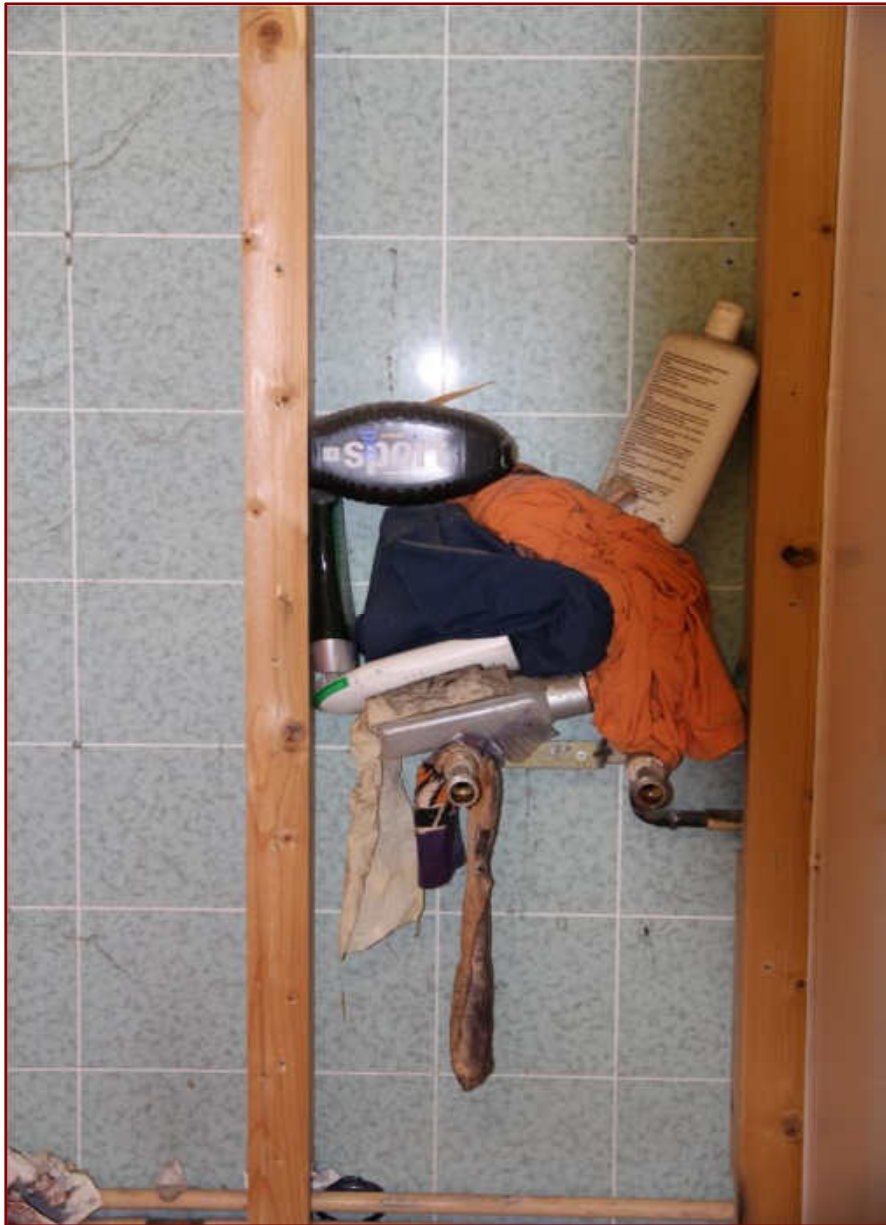
Wer hat sein Duschbad hier vergessen? Davon haben wir eine ganze Schubkarre voll ... Hinter jeder Zwischenwand eine neue Überraschung.
